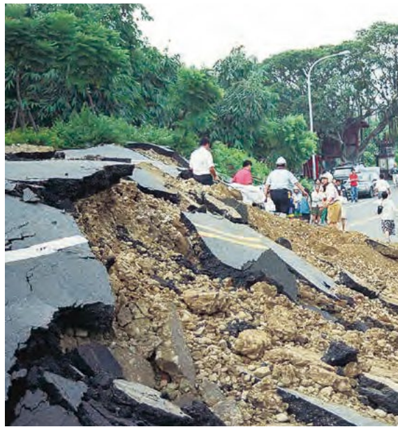
2 地震で盛り上がった路面 (台湾, 1999年)
